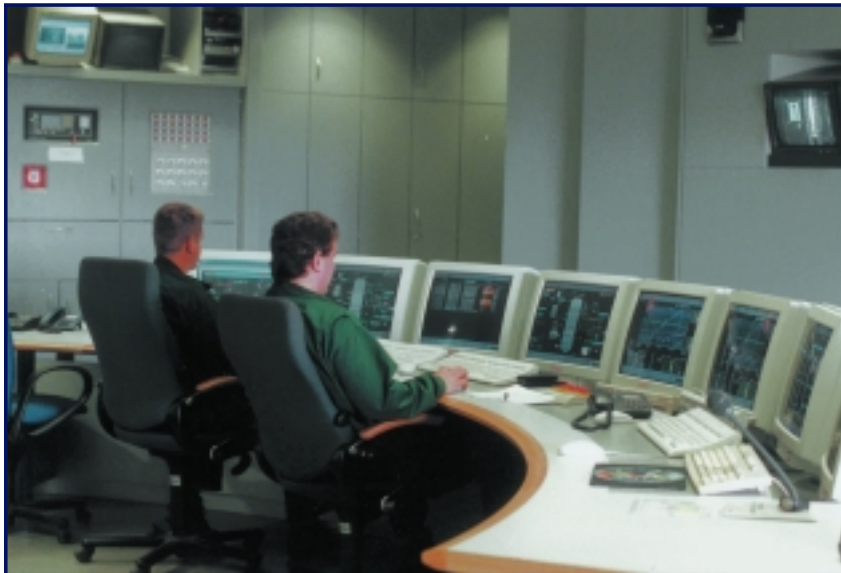
Die Leitwarte des Müllheizkraftwerkes in Pirmasens
